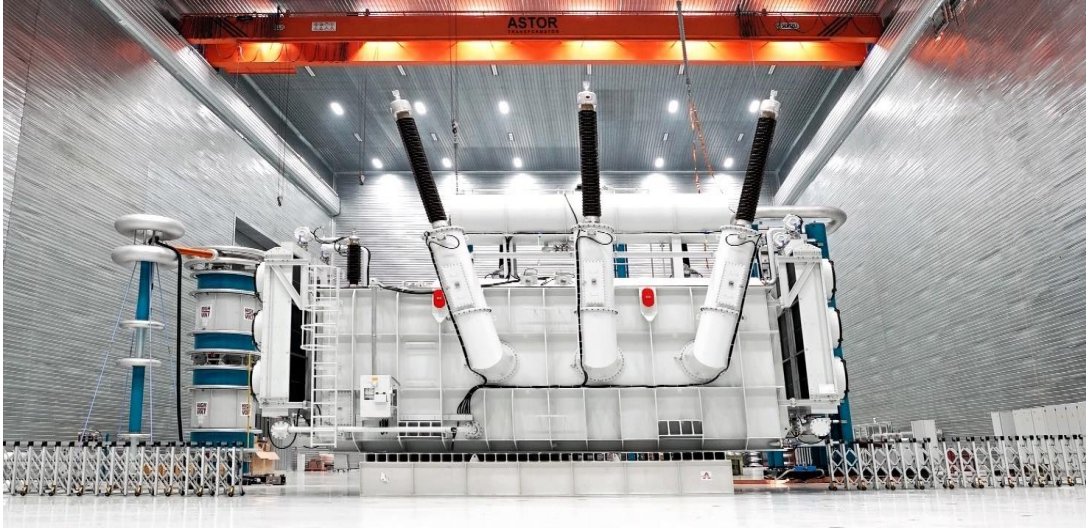
Astor Enerji Test Laboratuvarından bir bölüm
